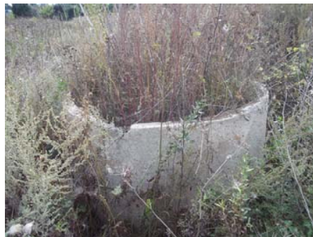
Рисунок 2. Нарушение состояния ЗСО 1 пояса водозабора.
