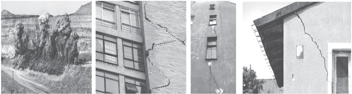
Рис. 1 – Разрушение зданий , вызванное сейсмическими воздействиями буровзрывных работ
