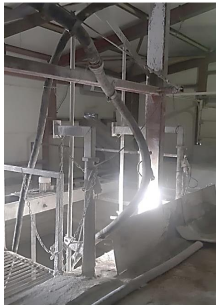
Рис. 3. Коммуникации для откачки грязной воды
